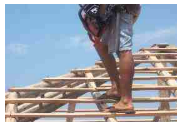
Trabalhador caminha, sem a mínima segurança, sobre telhado de pinus, nas casas do Loteamento
