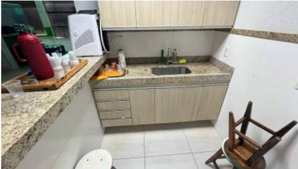
FOTO 27 - VISTA DA CANTINA COM ACABAMENTOS DE ALTO PADRÃO E ASPECTO DE NOVO
