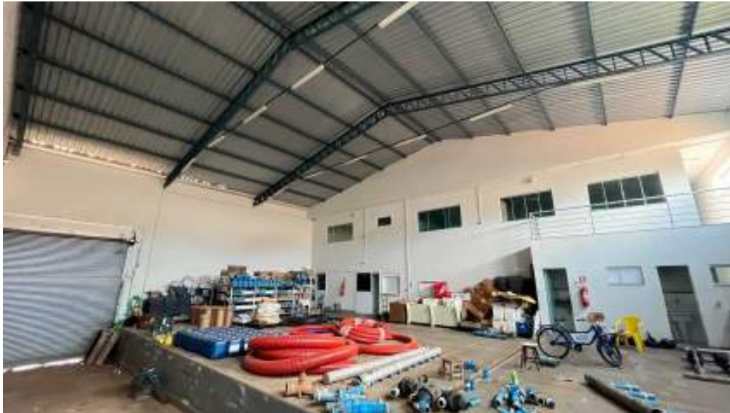
FOTO 33 - VISTA DO GALPÃO POSTERIOR COM TODAS INSTALAÇÕES NECESSARIAS DE PRIMEIRA QUALIDADE E COM ASPECTO DE NOVO
