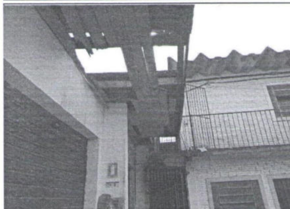
Foto da construção com telhado quebrado
