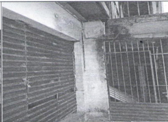
Imagem do péssimo estado de conservação do imóvel
