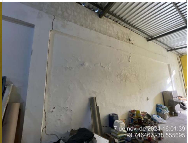
Figura 10 - Vista geral de anomalias do imóvel avaliando.
