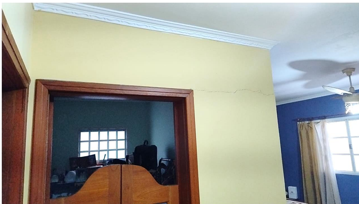
Foto 30 – Detalhe de trinca na parede na suíte 1
