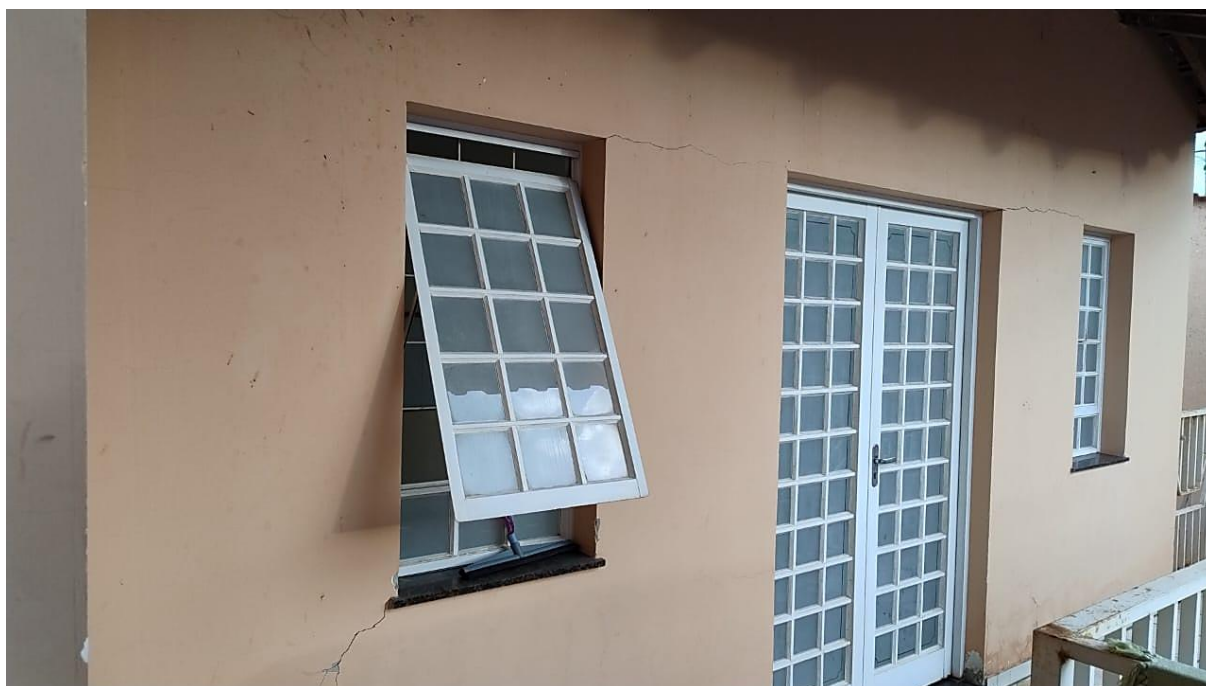
Foto 23 – Detalhe de trinca na parede na varanda no andar superior
