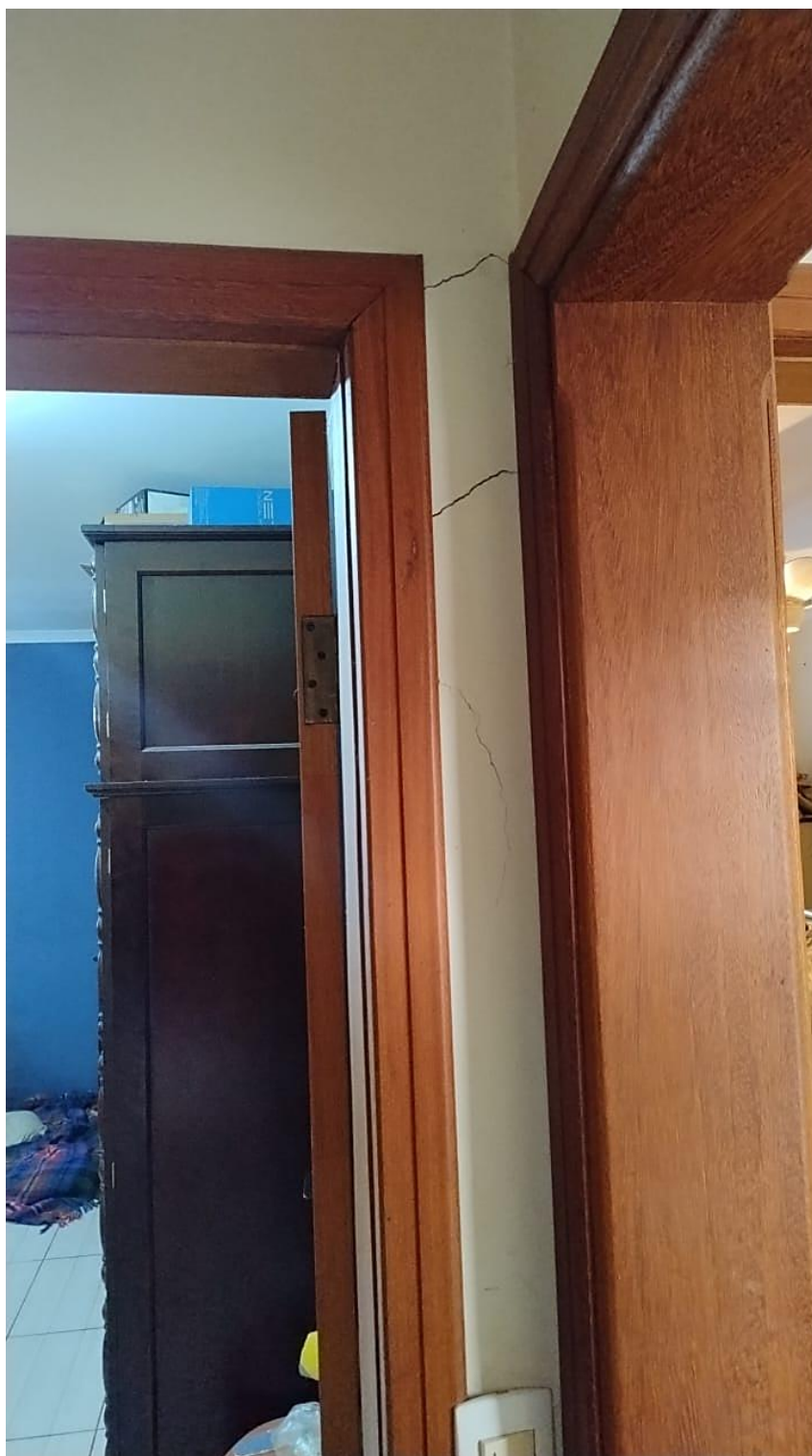
Foto 27 – Detalhe de trinca na parede junto aos dormitórios
