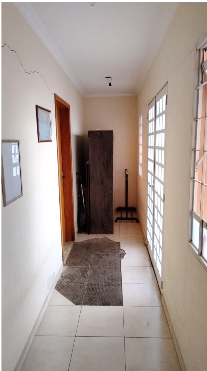
Foto 25 – Vista do corredor de distribuição dos dormitórios, detalhe da trinca na parte superior da parede
