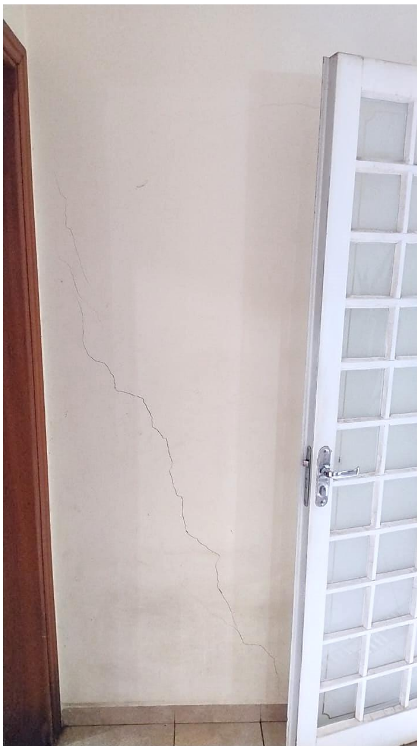
Foto 26 – Detalhe de trinca na parede junto aos dormitórios
