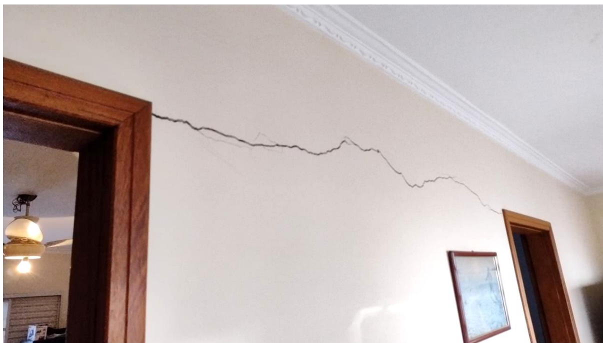
Foto 36 – Detalhe de trinca na parede junto aos dormitórios
