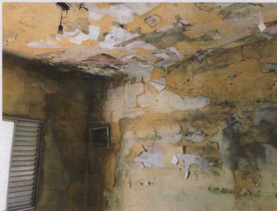
Foto 10- Aspecto de um dormitório (infiltrações).
