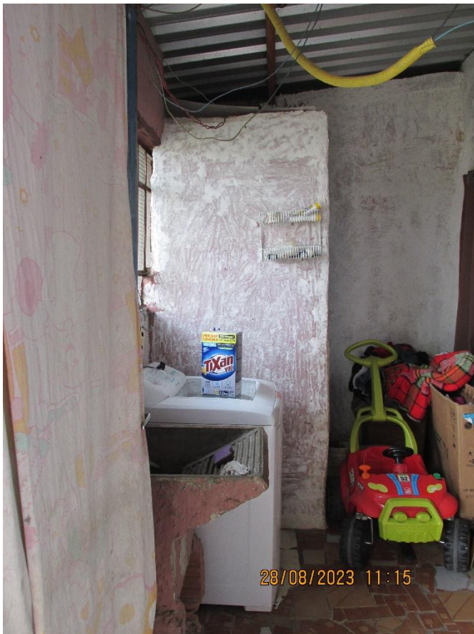
Lavanderia (ângulo I)
