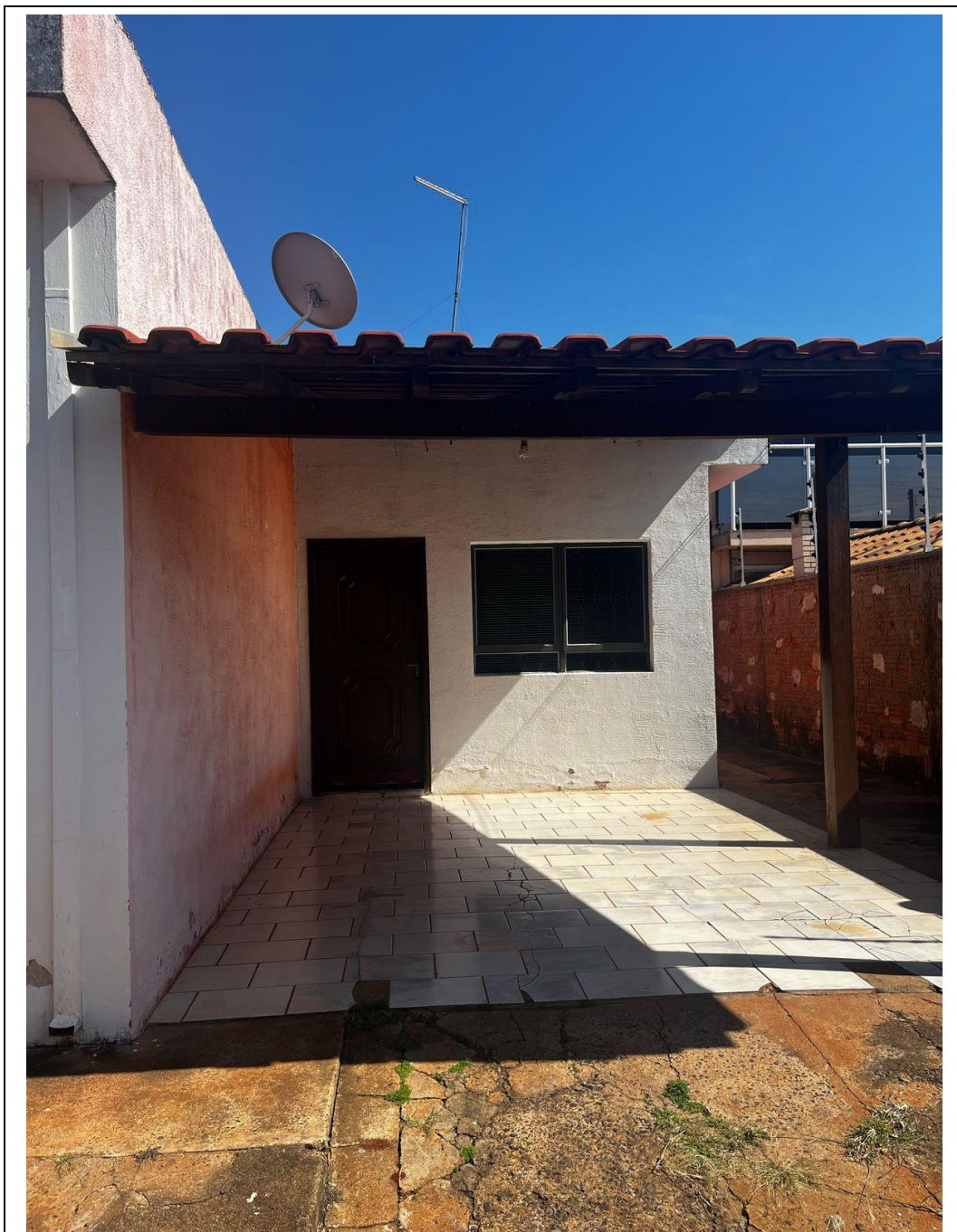
FOTO 03 – Vista parcial da parte frontal da residência. Nota-se a muro lateral sem reboco e pequenos desgastes na parte inferior da parede abaixo da janela
