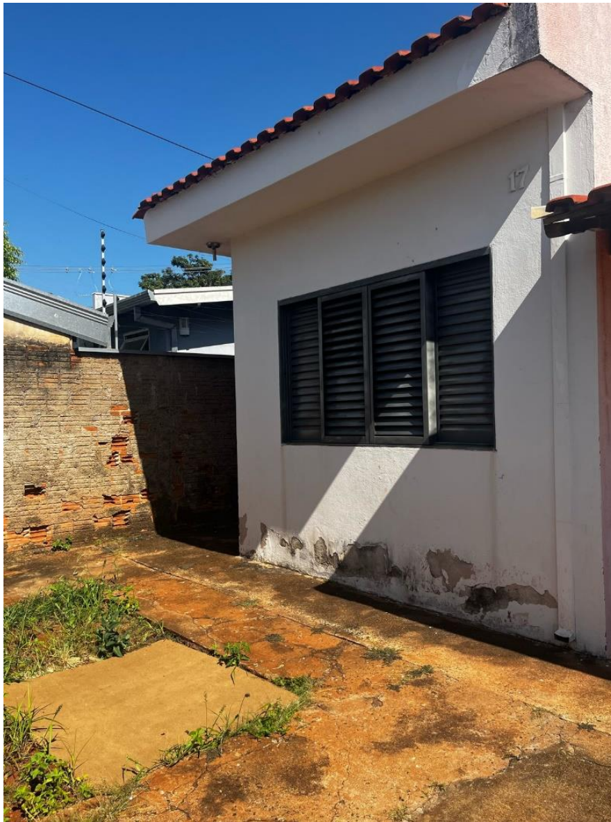
FOTO 02 – Vista parcial da parede frontal da residência. Nota-se umidade na parte inferior da casa e muro lateral sem reboque.
