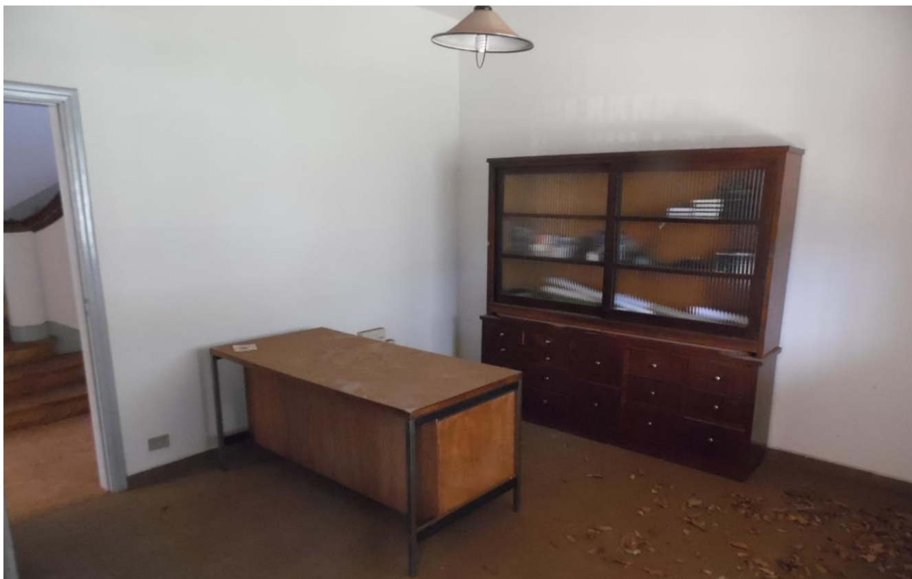
Imagem 10 – Interior do imóvel, Hall de Entrada - piso cerâmico, instalação elétrica embutida, paredes rebocadas e pintura em bom estado, em boas condições de conservação/manutenção.
