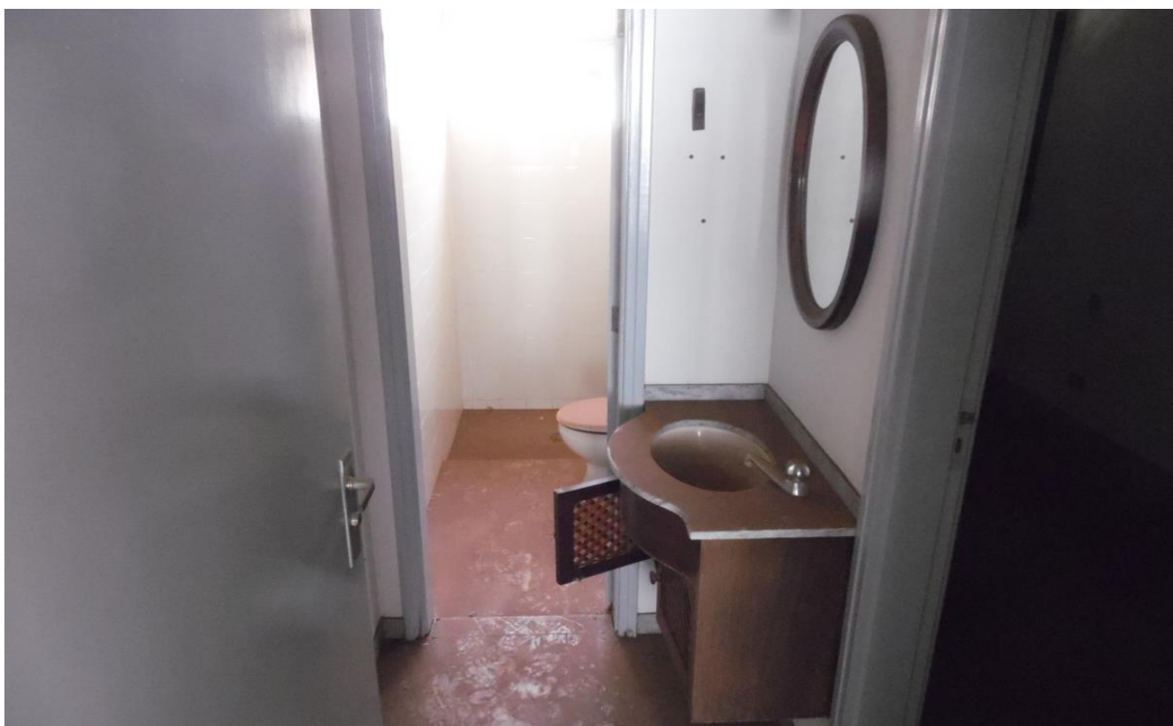
Imagem 14 – Lavabo - pisos cerâmicos, revestimentos até o teto, instalação hidráulica e elétrica embutida, Louças e Metais sanitários antigos mas de boa qualidade, também em boas condições.
