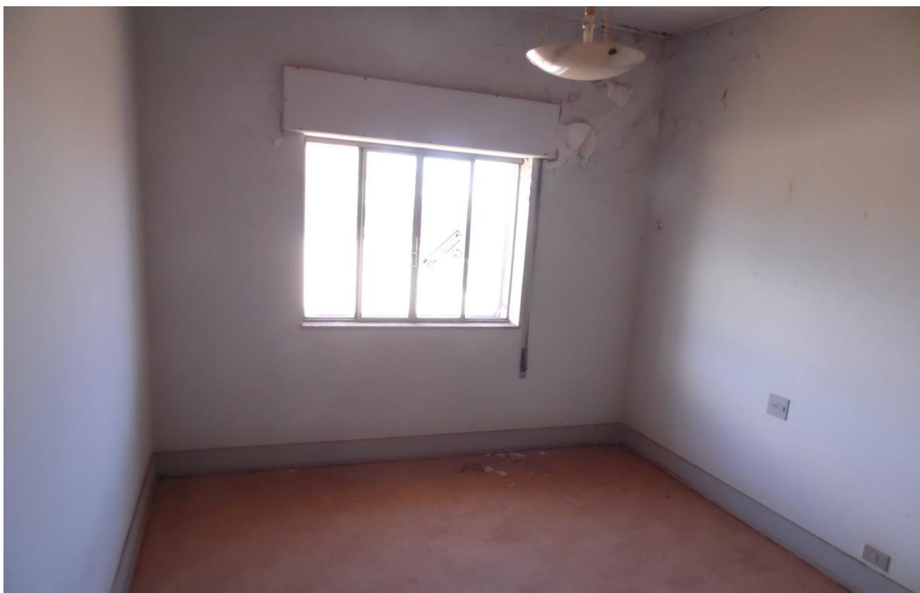
Imagem 22 – No entanto, em um dos Dormitórios foi constatado um problema de infiltração de águas pluviais que está deteriorando a pintura no local, dano/problema de pequena gravidade.
