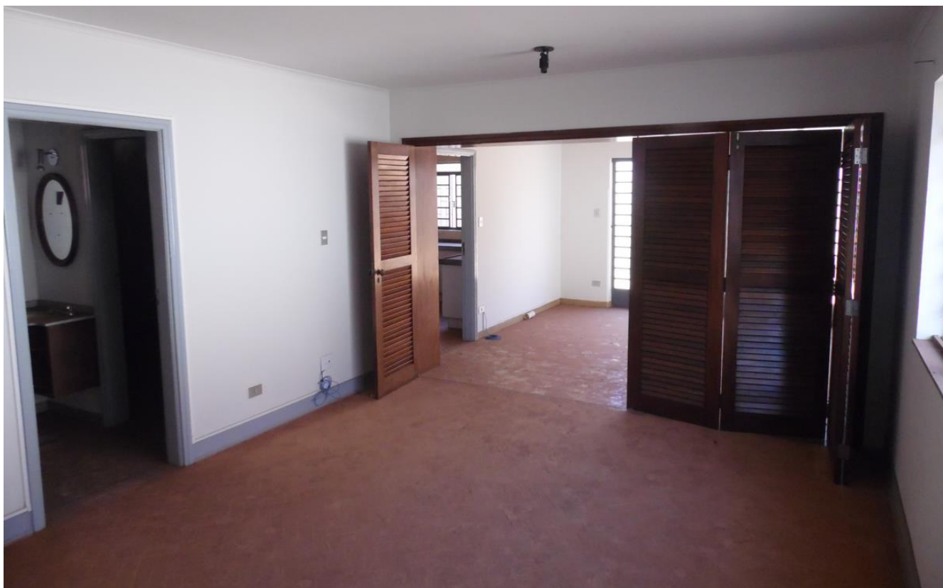
Imagem 13 – Sala de Jantar - tacos de madeira, esquadrias em madeira, instalação elétrica embutida, paredes rebocadas e pintura em bom estado, em boas condições e sem danos.
