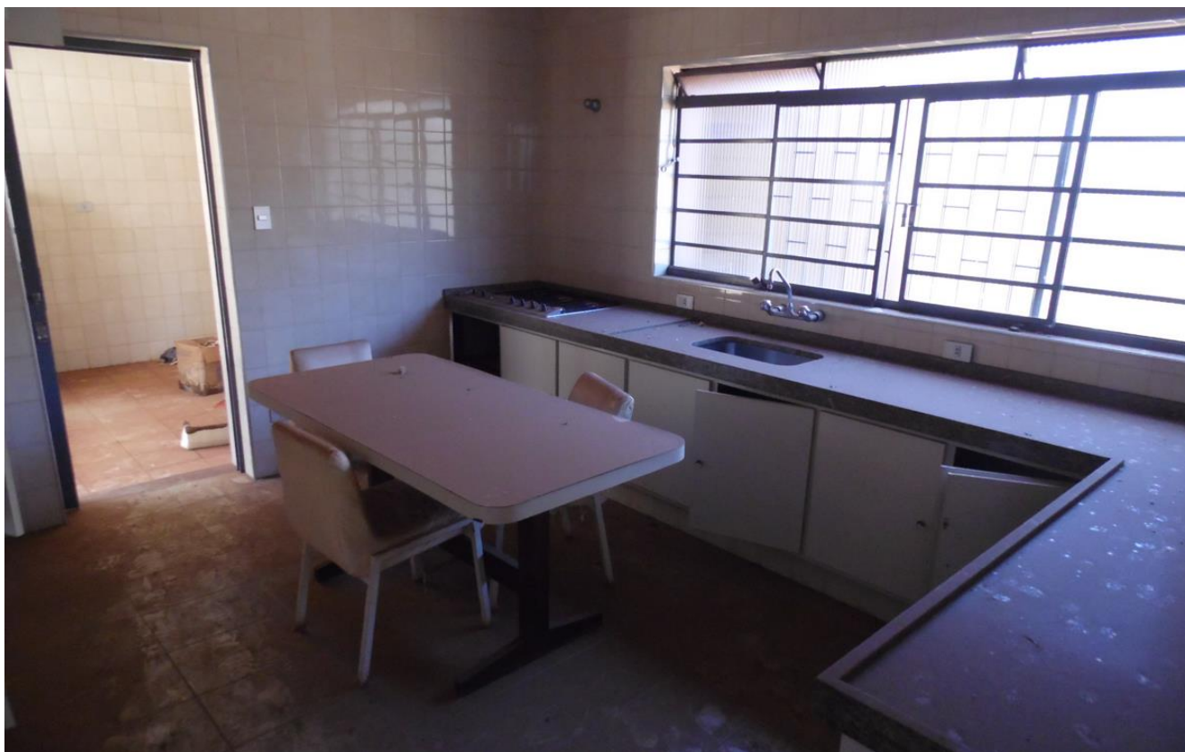
Imagem 15 – Cozinha - pisos cerâmicos, revestimentos até o teto, instalação hidráulica e elétrica embutida, esquadria em metal, bancadas em granito, gabinete planejado e armários embutidos.
