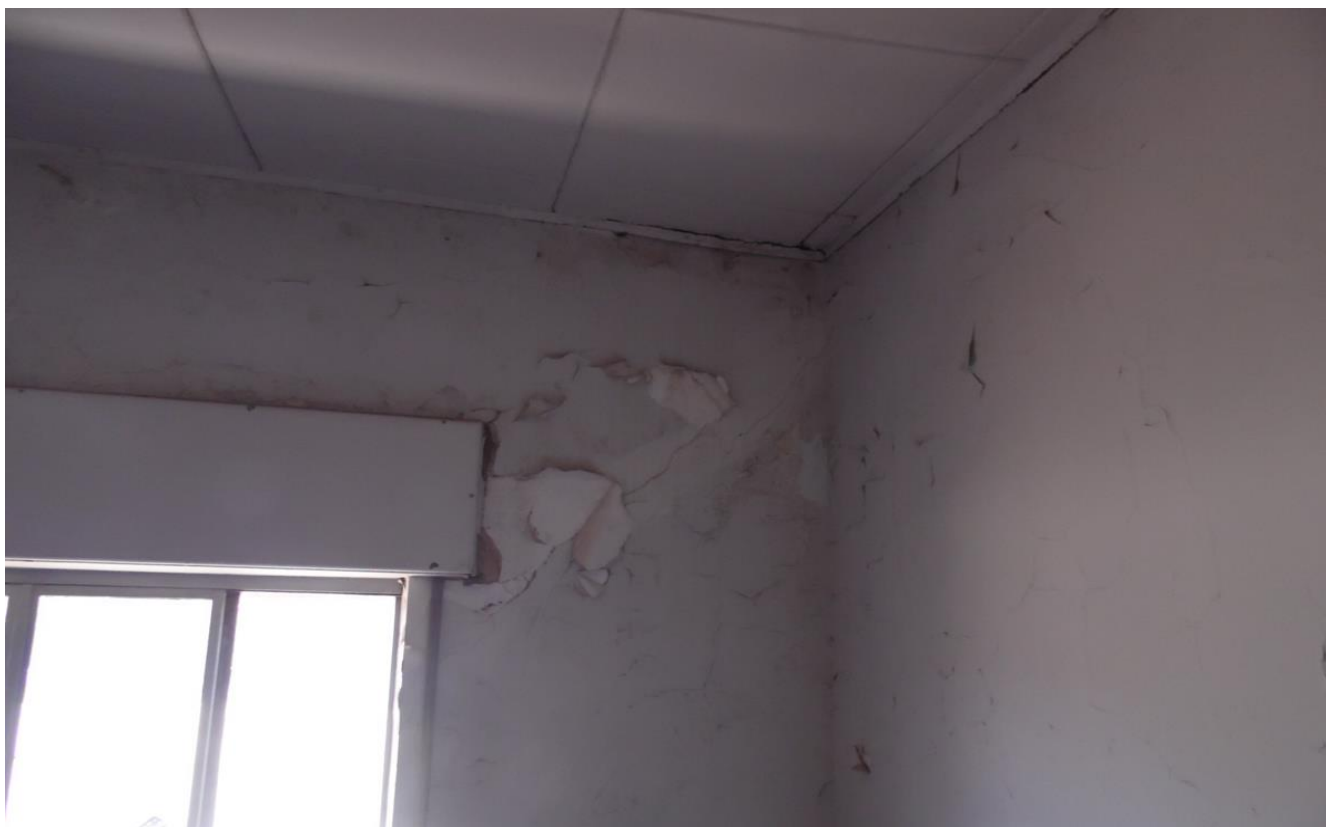
Imagem 23 – O problema de infiltração de águas pluviais que está deteriorando a pintura em um dos Dormitórios, ocorrência de pequena gravidade eliminada com reparos adequados.
