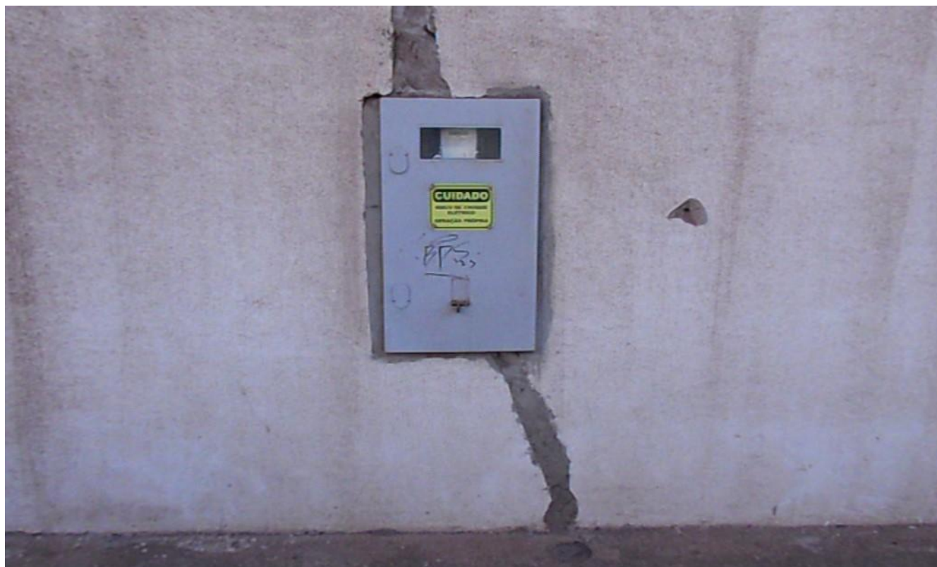
Imagem 04 – De qualquer maneira, mesmo não sendo possível o acesso ao interior do Edifício, foi constatado que o equipamento está adequadamente instalado e funcionando sem problemas conforme as informações obtidas ao se inspecionar o Medidor Eletrônico de Energia Elétrica.
