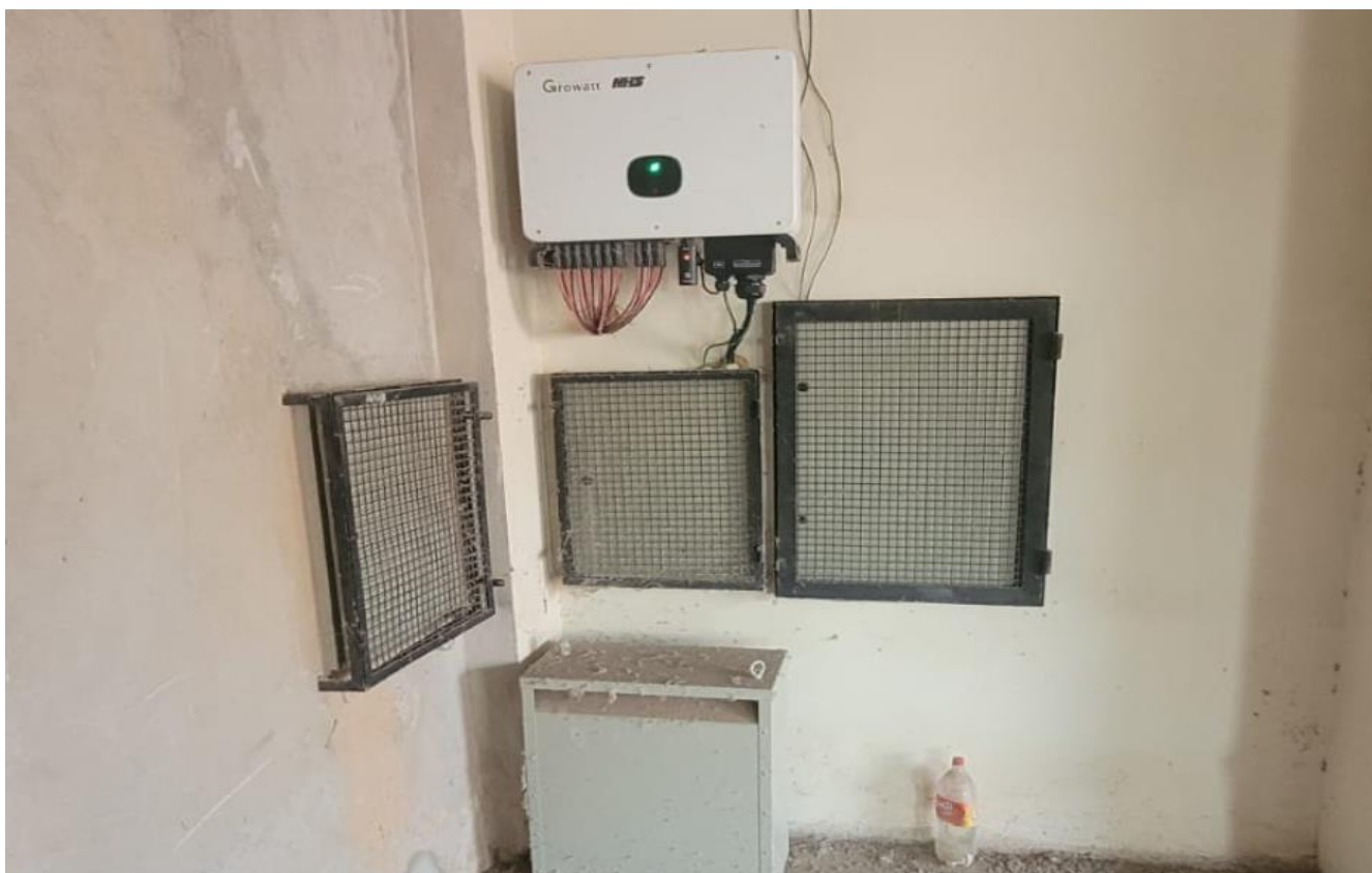
Imagem 06 – O Inversor fotovoltaico, conforme já esclarecido, adequadamente instalado e funcionando sem problemas - imagem registrada pelo Oficial de Justiça que esteve no local.
