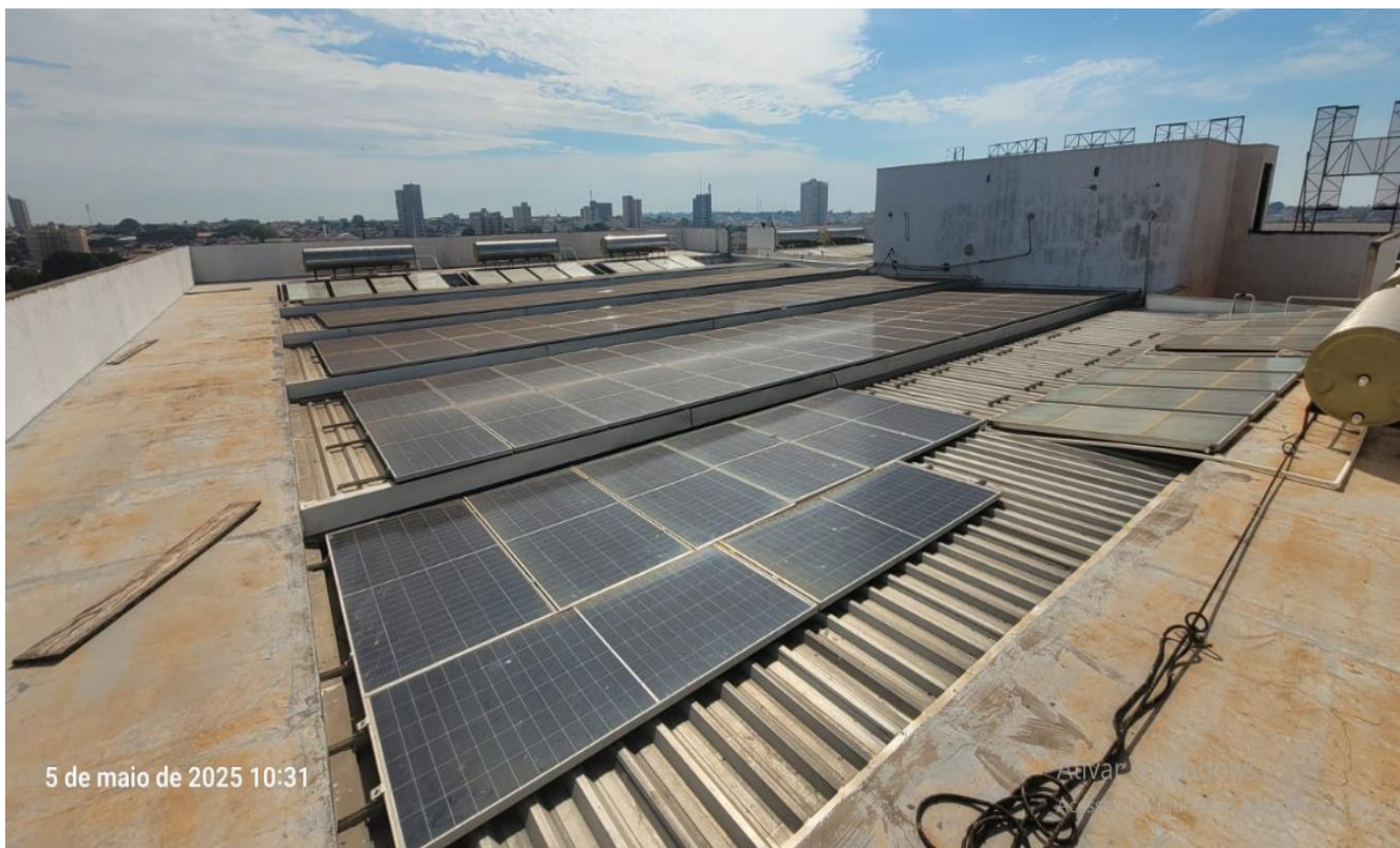
Imagem 07 – Módulos fotovoltaicos instalados no Edifício Sede do Lumiere Executive Hotel, funcionando sem problemas - imagem registrada pelo Oficial de Justiça que esteve no local.
