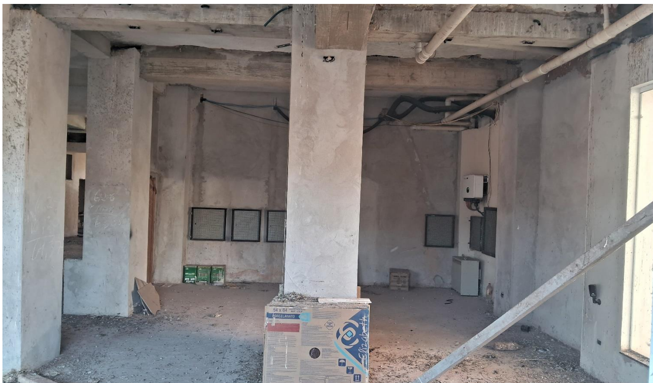
Imagem 05 – Também foi possível constatar o local onde o Inversor fotovoltaico está instalado, no saguão de entrada do Edifício, e como já esclarecido, ele está funcionando sem problemas.
