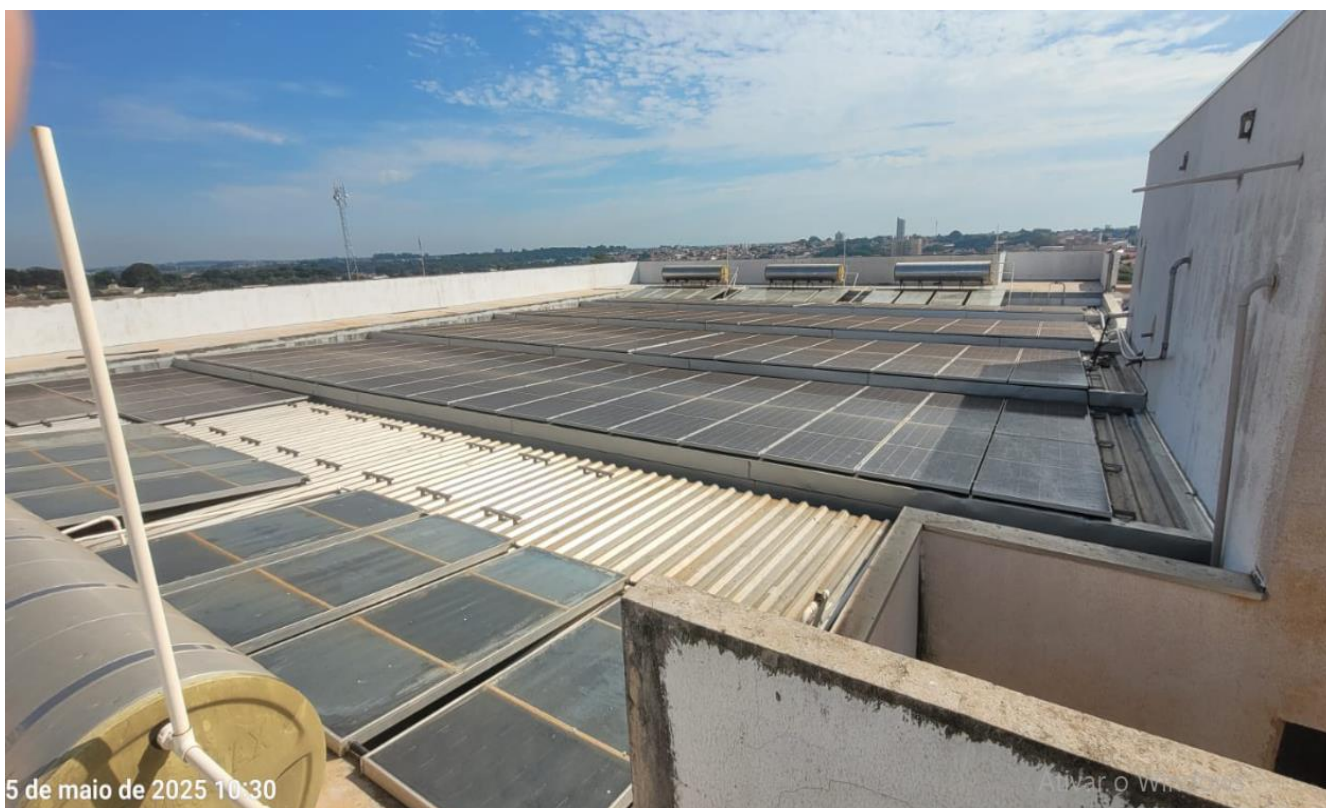
Imagem 10 – Módulos fotovoltaicos instalados no Edifício Sede do Lumiere Executive Hotel, funcionando sem problemas - imagem registrada pelo Oficial de Justiça que esteve no local.
