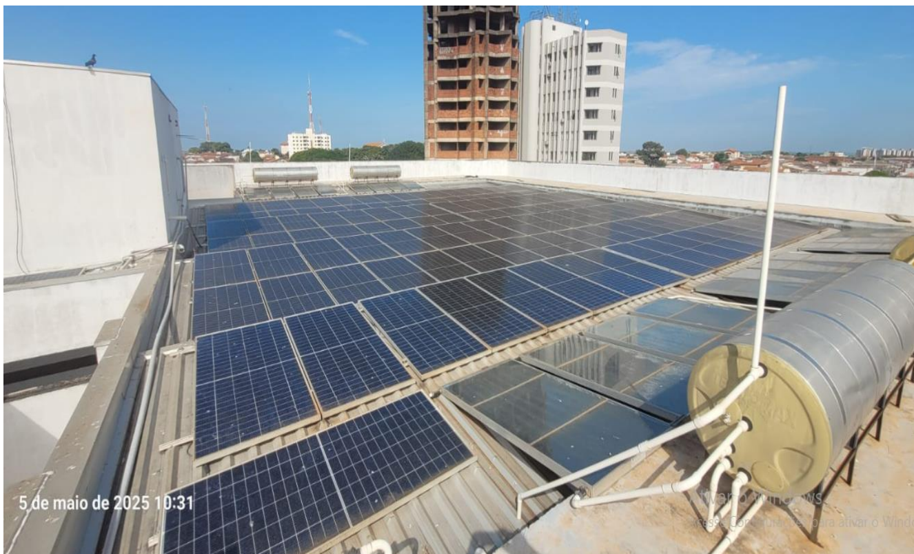
Imagem 09 – Módulos fotovoltaicos instalados no Edifício Sede do Lumiere Executive Hotel, funcionando sem problemas - imagem registrada pelo Oficial de Justiça que esteve no local.
