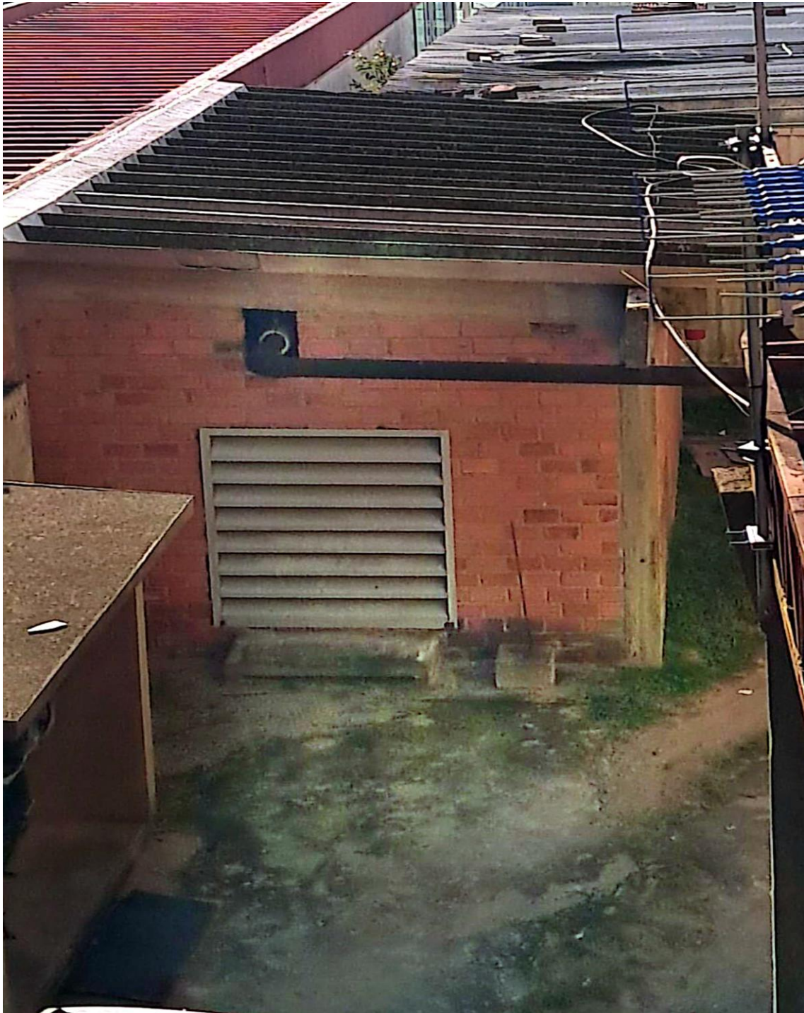
Figura 7 Onde fica o Gerador
