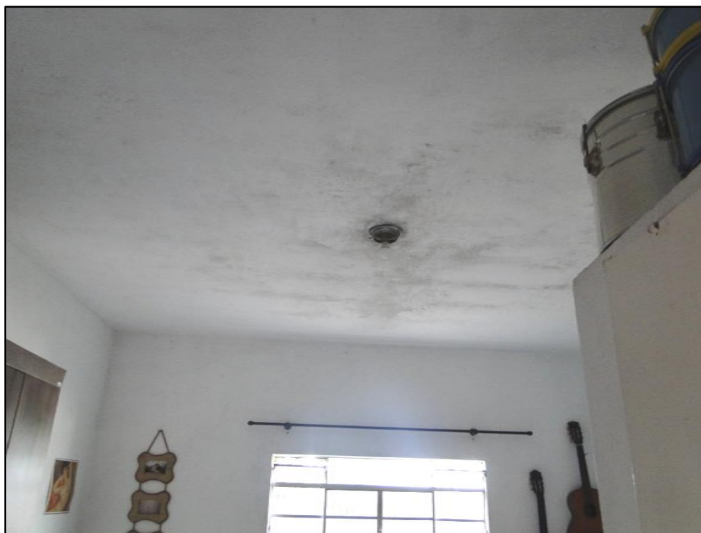
FOTO 06: Evidências de infiltrações de umidade na laje-forro do dormitório frontal.
