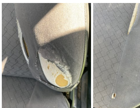
Figura 9 – Danos nos bancos.
