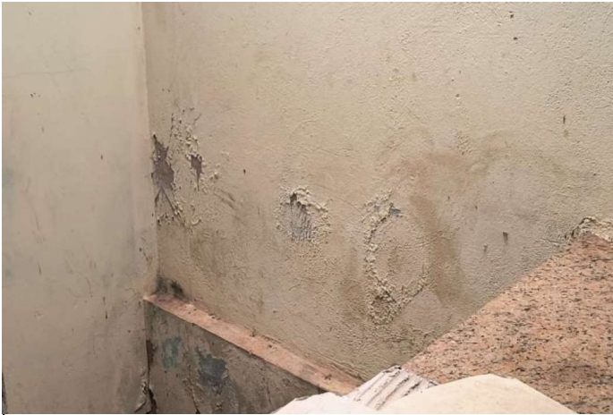
Foto 20 - Vícios construtivos(descascamento e umidade)
