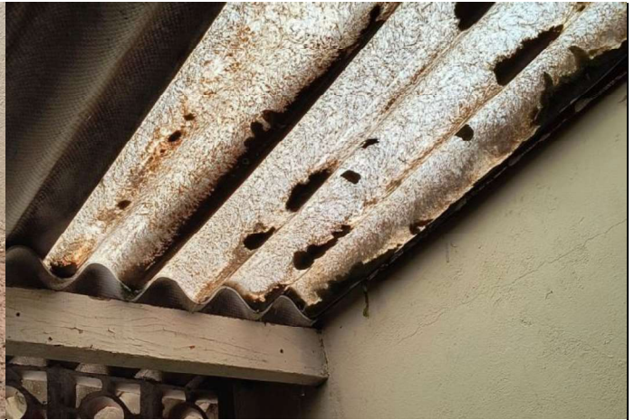
Foto 21 - Telhas do fundo
