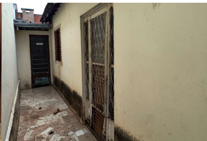
Foto 06 - Acesso casa - Fechado
