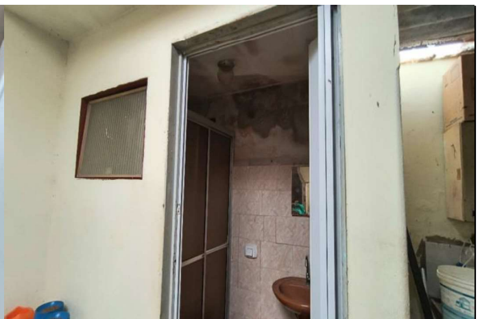
Foto 23 - Acesso ao banheiro do fundo(umidade/infiltração)
