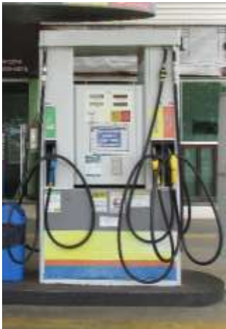
Figura 7 - Vista Frontal Bomba 01
