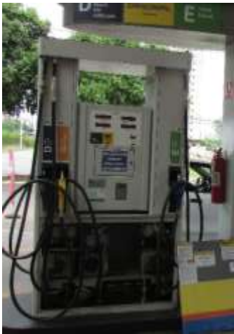
Figura 9 - Vista Frontal Bomba 03
