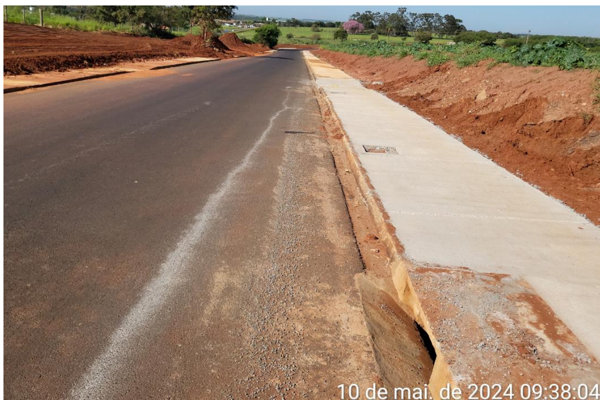
Foto 09: Guia, sarjeta e boca coletora de água pluvial (microdrenagem)
