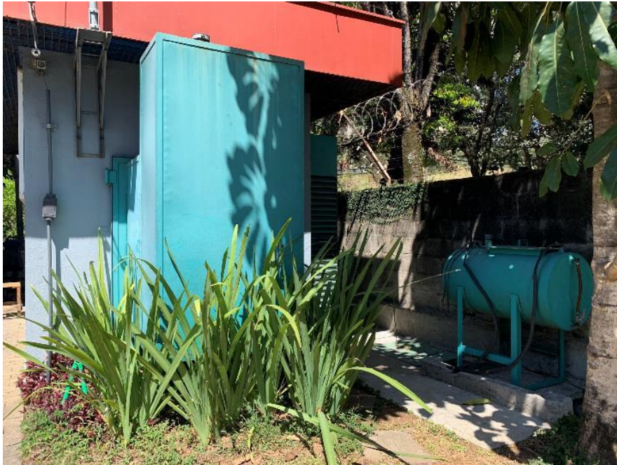
Foto 57 – Portaria com destaque ao gerador do imóvel
