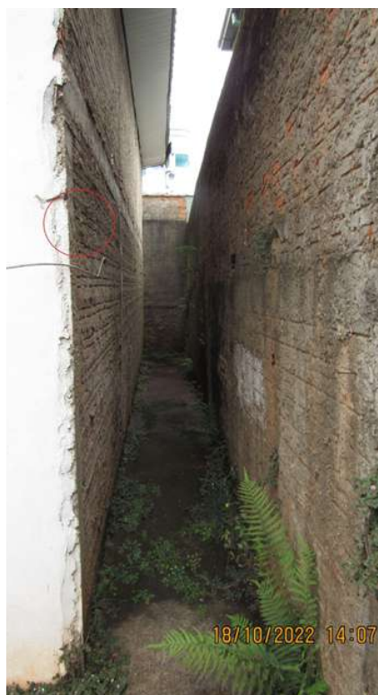
Foto 23, parede (fundos) da residência 1 sem emboço, reboco e pintura, fonte: Autoria própria
