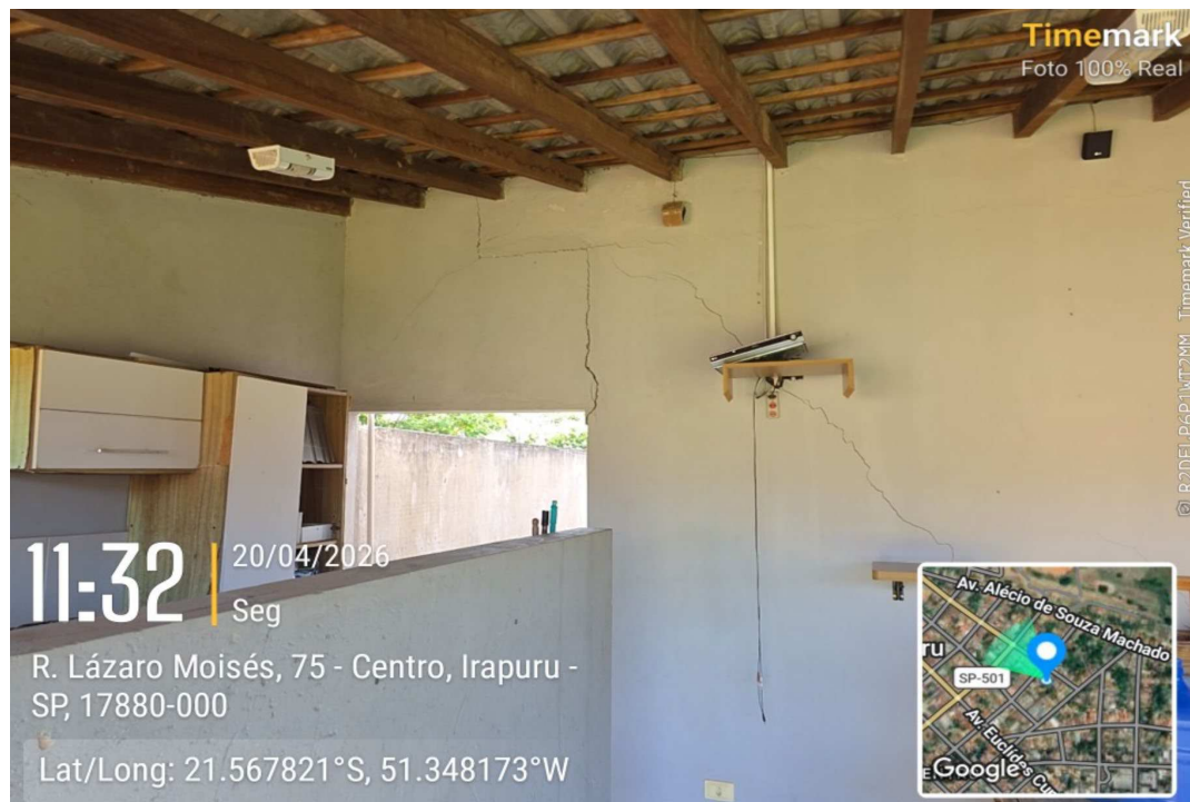
Outras trincas na alvenaria da construção principal
