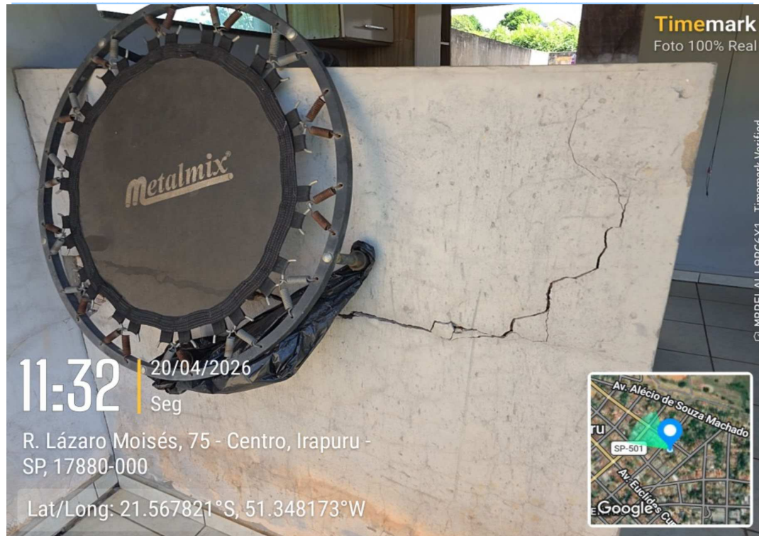
Trincas na alvenaria localizada na varanda
