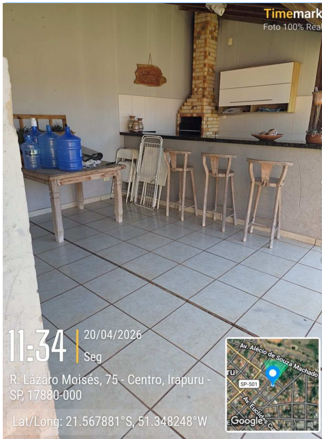
Outra foto mostrando danos no piso da varanda
