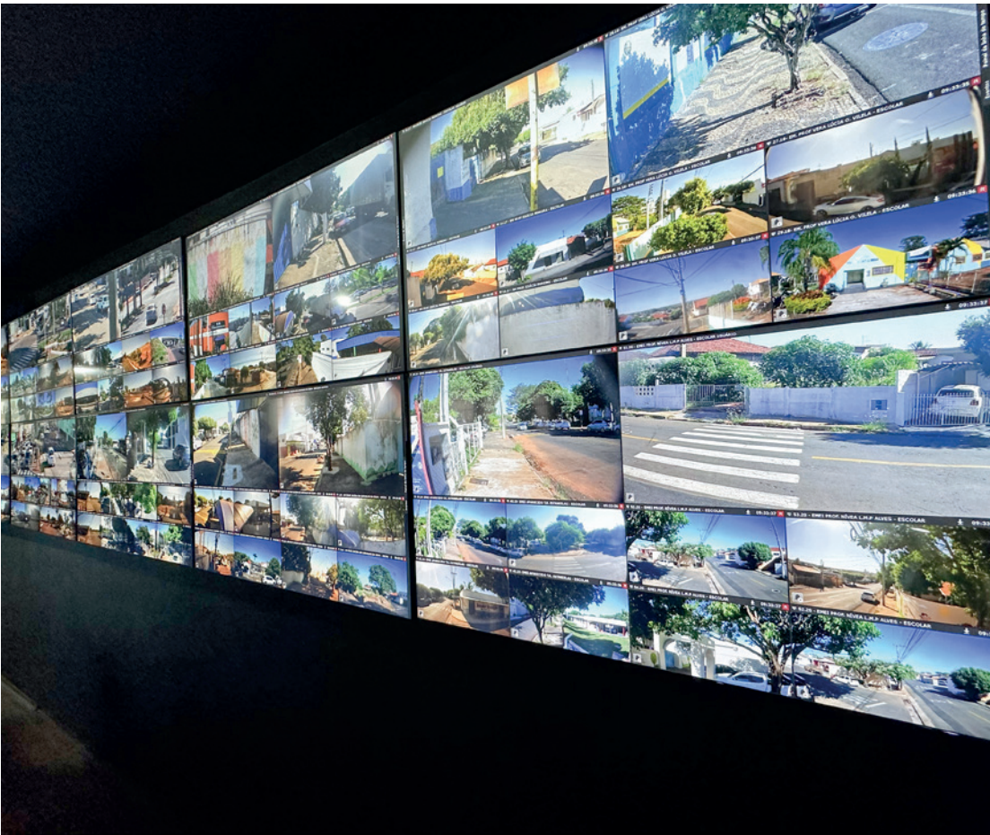
Central de Monitoramento localizada na Secretaria Municipal de Segurança Pública e Mobilidade Urbana
