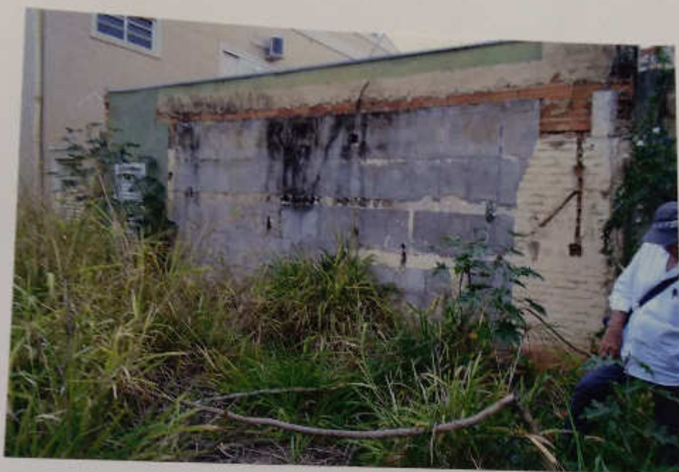
FOTO 02: MOSTRA A DIVISA DOS FUNDOS DO IMÓVEL, FECHADA COM MURO, VISTA DA ÁREA VERDE. OBSERVANDO QUE AS BENFEITORIAS QUE ALI EXISTIAM FORAM TODAS DEMOLIDAS.
