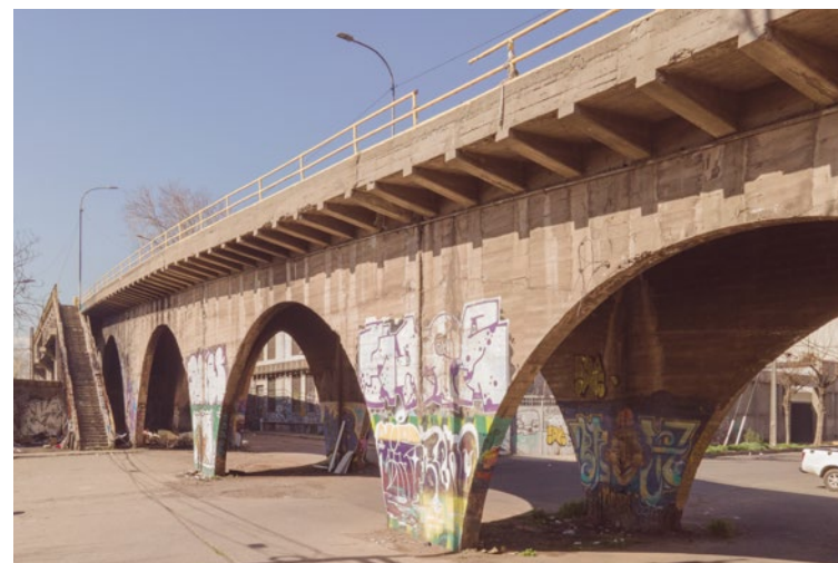
Figura 36 - 37. Vista inferior a pilares de Puente Superior Carrascal. Fuente: Municipalidad de Quinta Normal, 2024.
