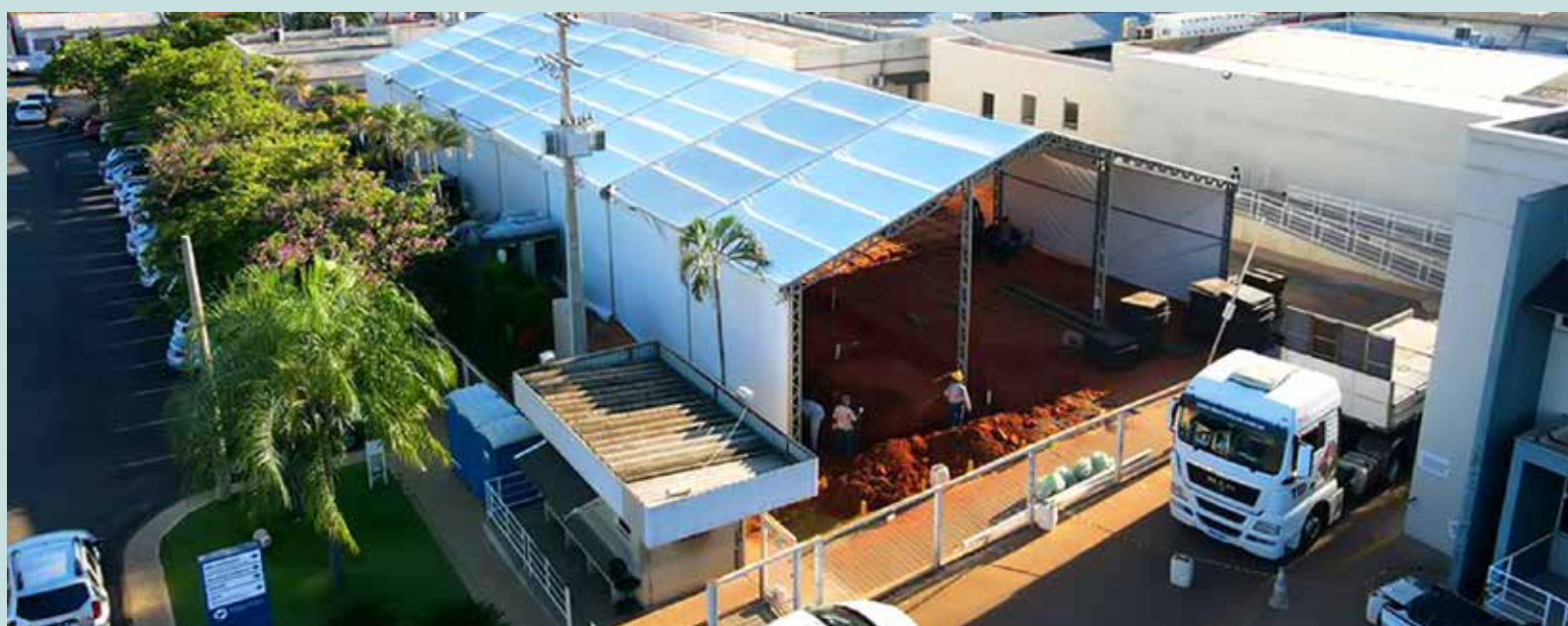
Hospital de campanha está sendo construído em Votuporanga para atender pacientes com Covid-19
