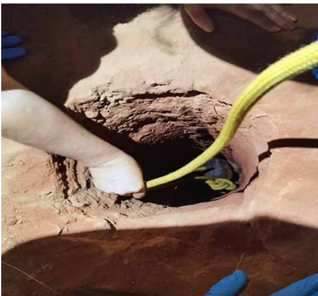
O buraco faz parte da estrutura do alicerce de um imóvel em construção e estava desprotegido
