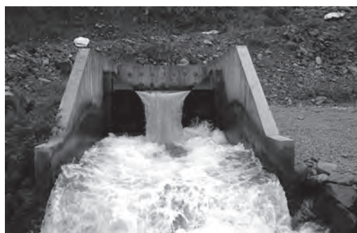
FIG. 9.9 Campos Novos: medidor de vazão em operação (out./2007)
