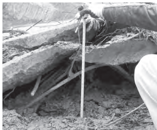
FIG. 3.15 Ruptura das juntas centrais de compressão da barragem Campos Novos
