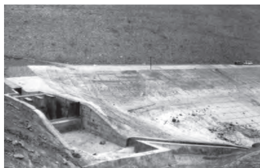
FIG. 9.8 TSQ1: medidor de vazão antes do enchimento do reservatório (out./2000)
