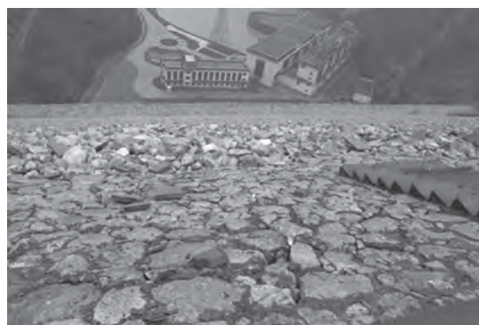
FIG. 1.6 Enrocamento “solto” no talude de jusante da barragem de Zipingpu (China)
