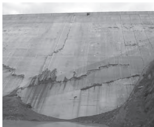
FIG. 3.14 Ruptura da laje da barragem Campos Novos
