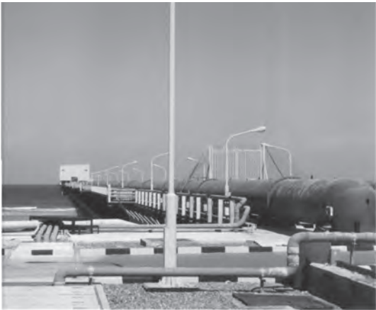
FIG. 9.3 Tubulações da tomada de água do Complexo de Ghubrah Fonte: USBR (2003).
