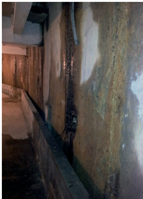
Fig. 6.14 Problemas de drenagem do subsolo em virtude da ausência de tratamento das juntas entre as lamelas e na posição dos tirantes
