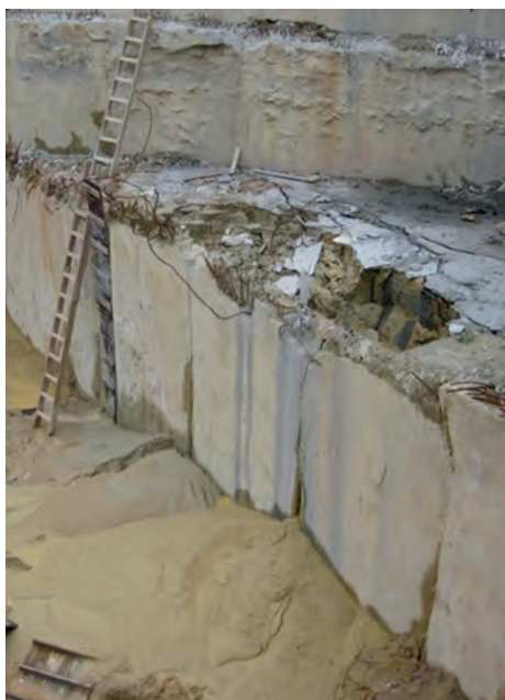
Fig. 6.13 Problemas de juntas entre as lamelas (falta de limpeza e elementos de junta não adequados), provocando carreamento de solo e instabilidade geral
