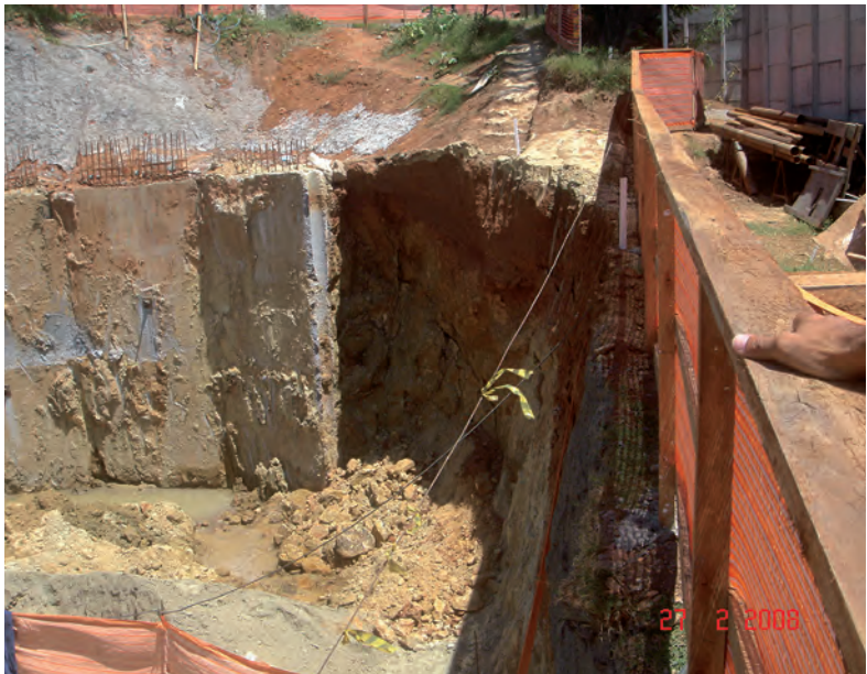
Fig. 6.23 Lamela com ficha pequena tombada em virtude da remoção da bermagem
