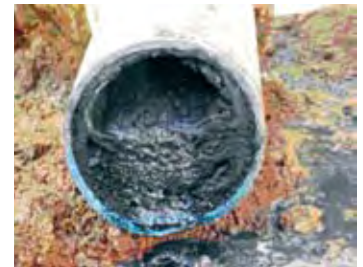
Fig. 5.16 Colmatção de tubo de percolado Fonte: Ferrari, 2005.
