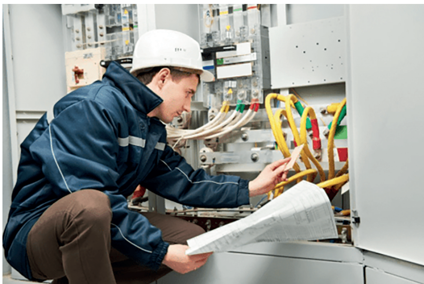
Figura 1.2 Inspeção em sistemas elétricos prediais com painel desenergizado.
