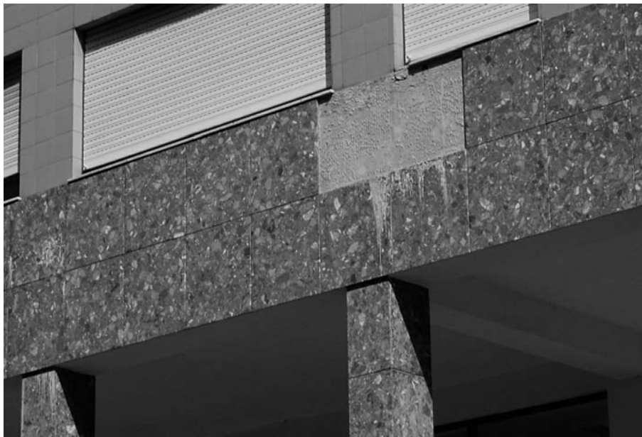
Figura 1. Descolamento de placa de granito por perda de aderência
