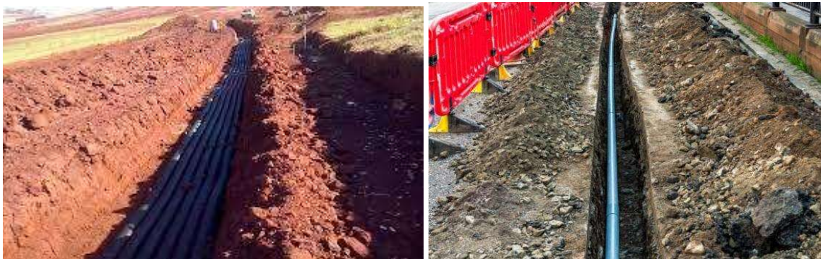
Imagem 6: Passagem subterrânea para eletrodutos
