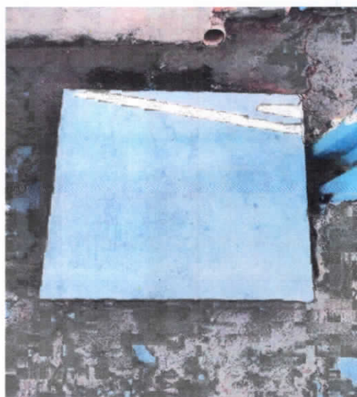
Tampa no piso quebrado
