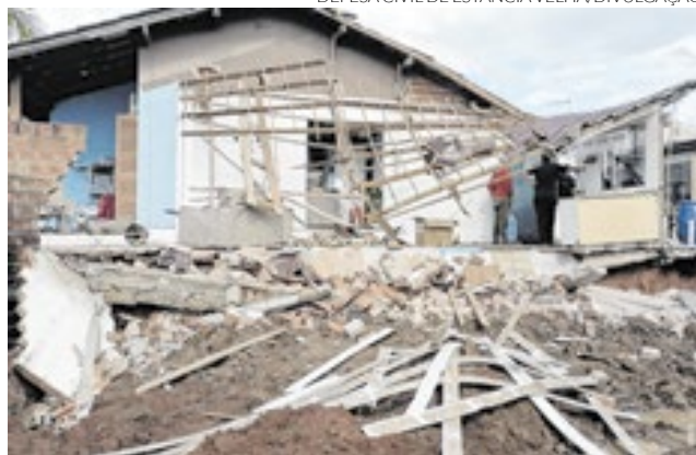
DEFESA CIVIL DE ESTÂNCIA VELHA/DIVULGAÇÃO Escavação em terreno provocou o desmoronamento de garagem na casa vizinha durante a manhã de sábado
