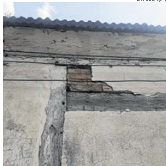
Outro exemplo de desgaste neste tipo de estrutura
