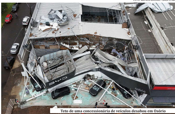
Teto de uma concessionária de veículos desabou em Osório
