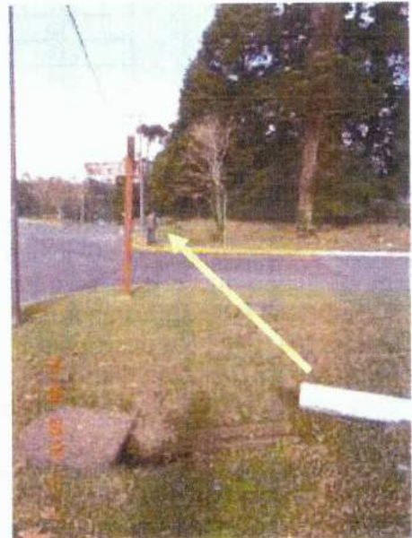
Foto 4. Sentido do fluxo d'água que sai do dreno.
