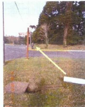
Foto 4. Sentido do fluxo d'água que sai do dreno.
